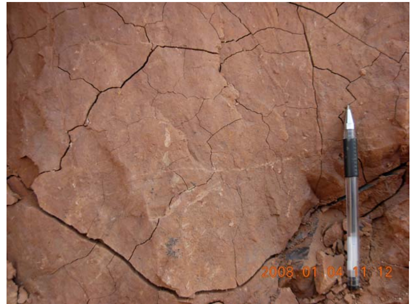
干缩裂隙（次生裂隙）
